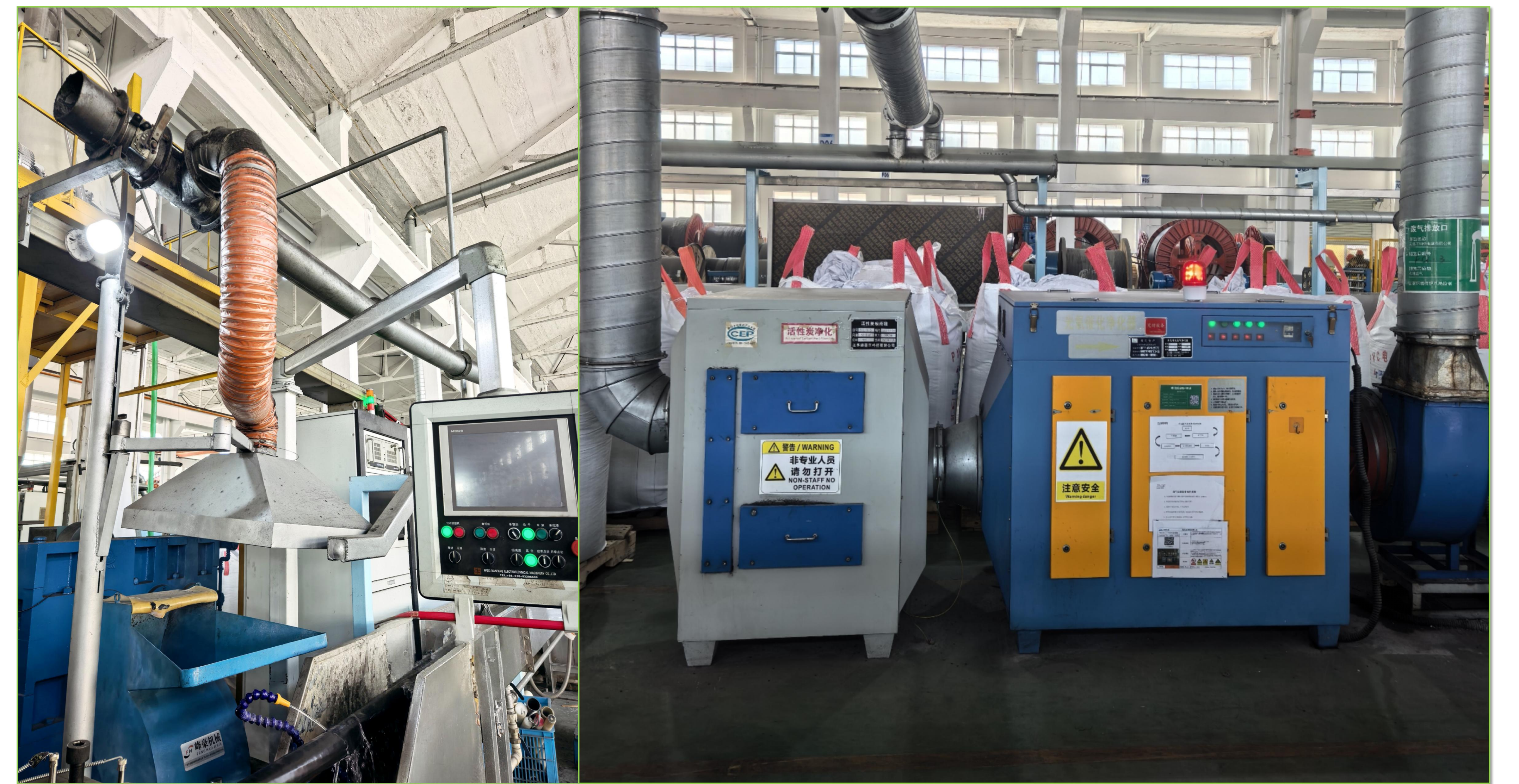
明珠电缆废气处理设备
